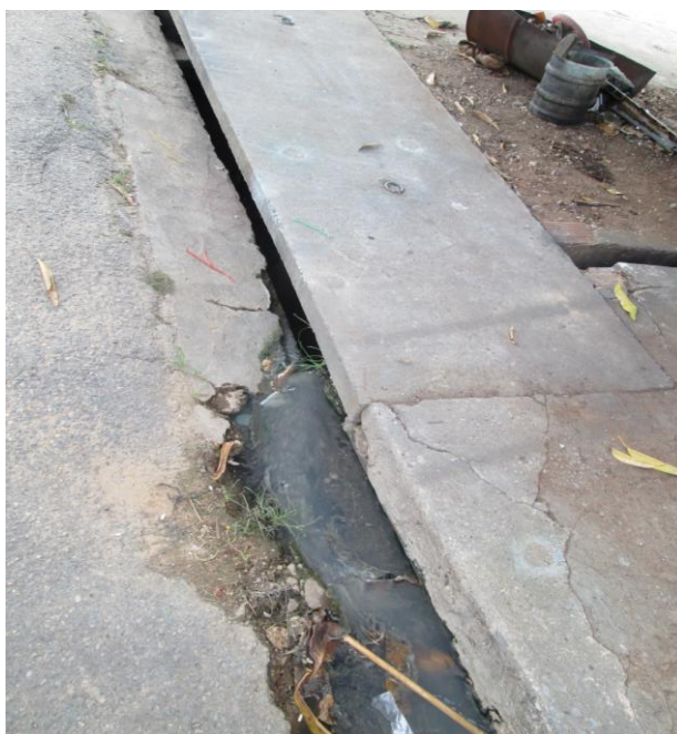
Figura 4 – Lançamento do esgoto em galeria de águas pluviais
