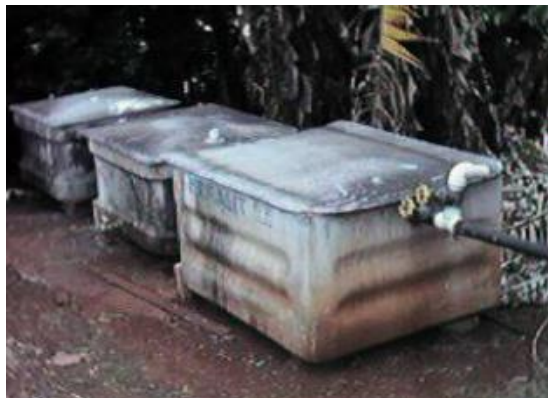
Figura 3: Tanque séptico utilizado na distribuição da água residuária.
