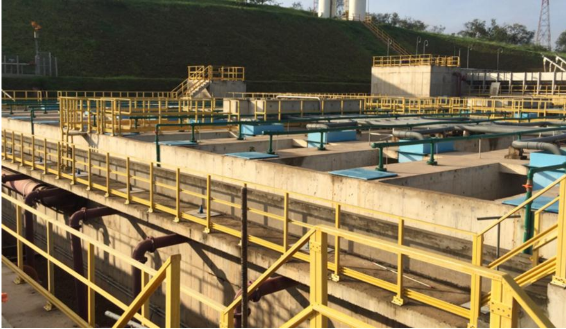
Figura 1- Vista dos reatores UASB 1A e UASB 1B, com “flare” em funcionamento ao fundo.
