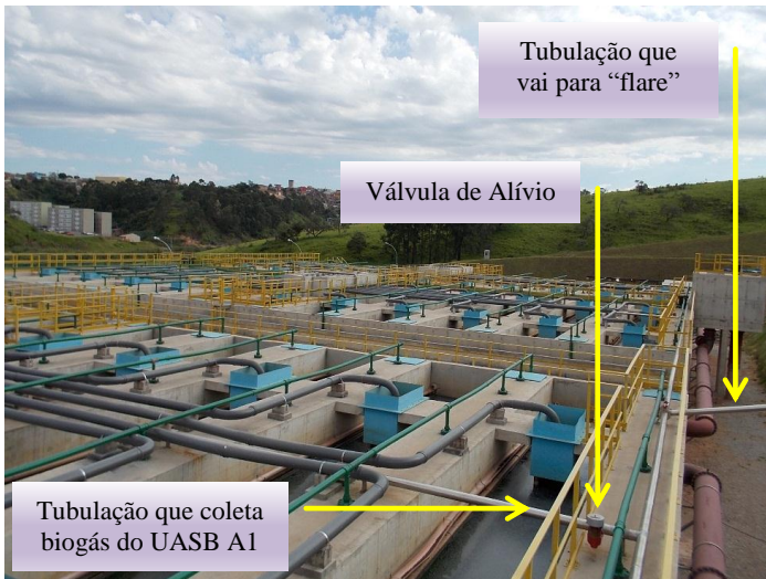
Figura 3 – Tubulação de biogás e válvula de alívio- UASB A1.
