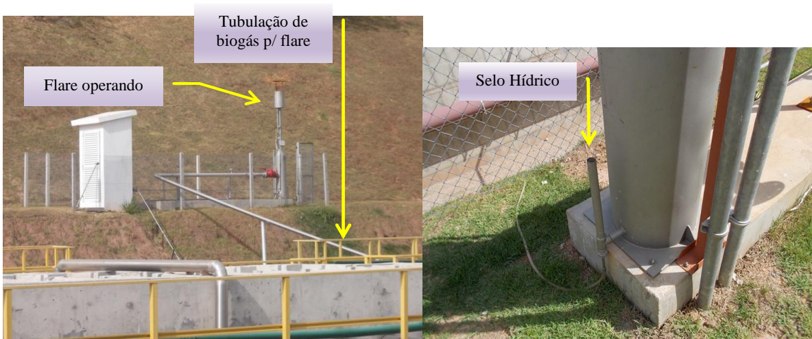
Figura 4- Vista do queimador tipo “flare” operando e detalhe do selo hídrico.
