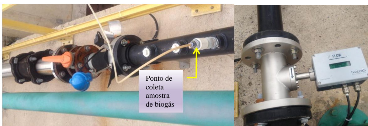
Figura 5 - Localização do medidor de biogás, instalado na linha de gás que sai do UASB 1A e do ponto de coleta de amostra de biogás para determinação da composição.
