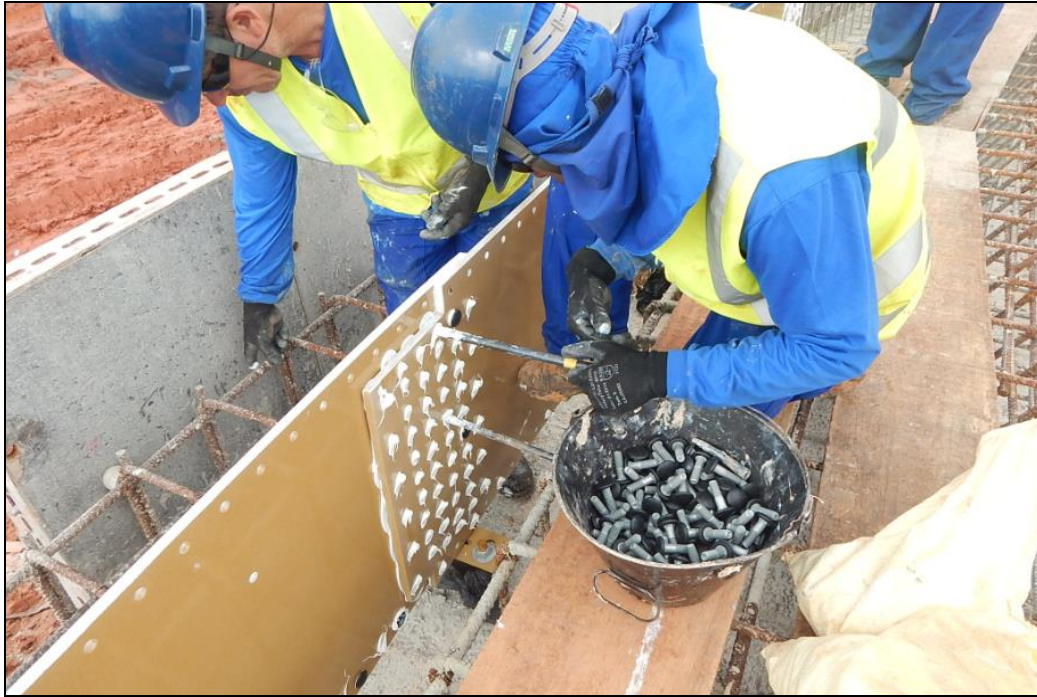
Figura 21 - Detalhe da instalação das chapas metálicas da primeira fileira de chapas na base do Reservatório - ETA V.G. do SPSL.
