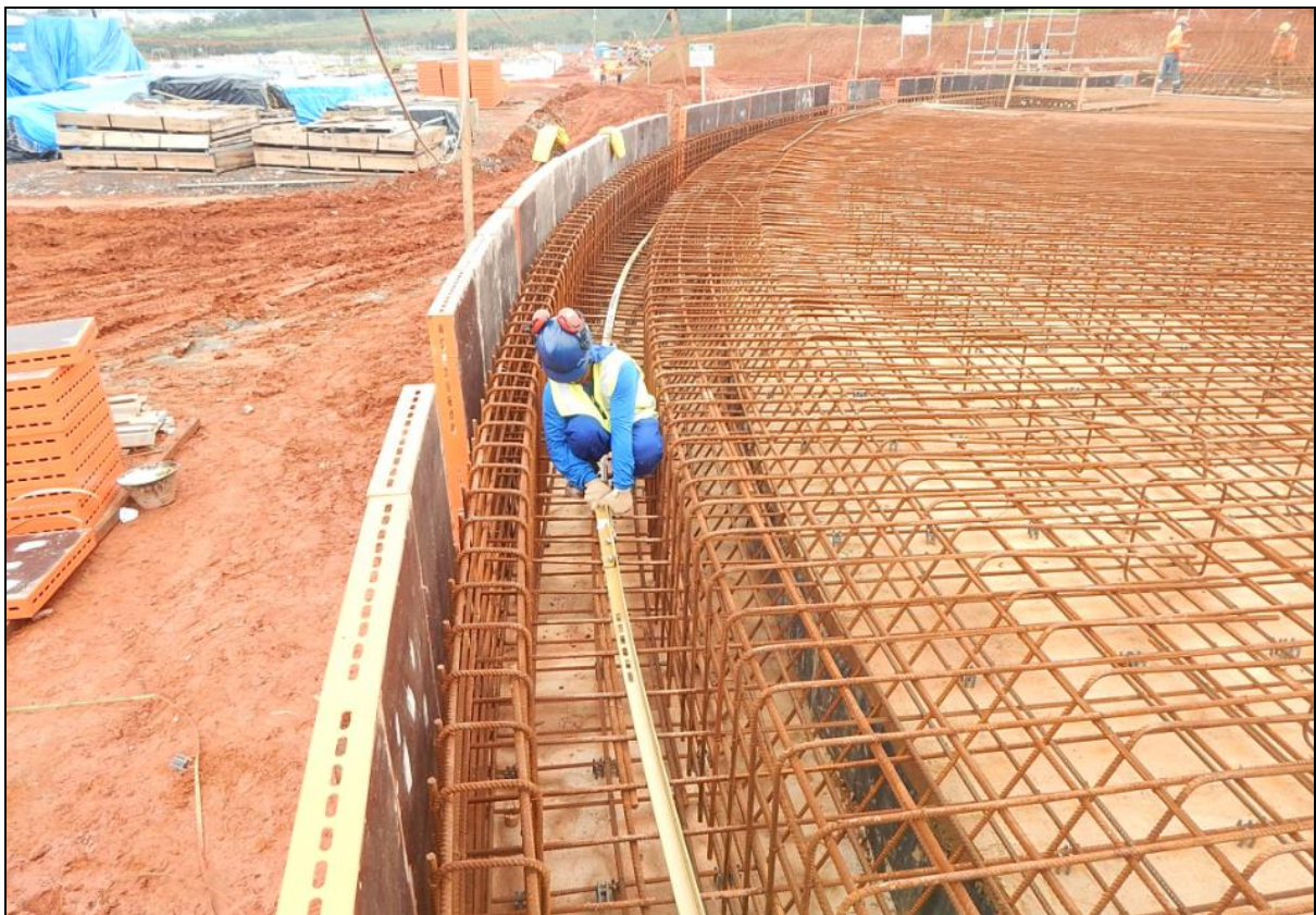
Figura 20 - Detalhe da instalação da base longarina de fixação da primeira fileira de chapas na base do Reservatório - ETA V.G. do SPSL.
