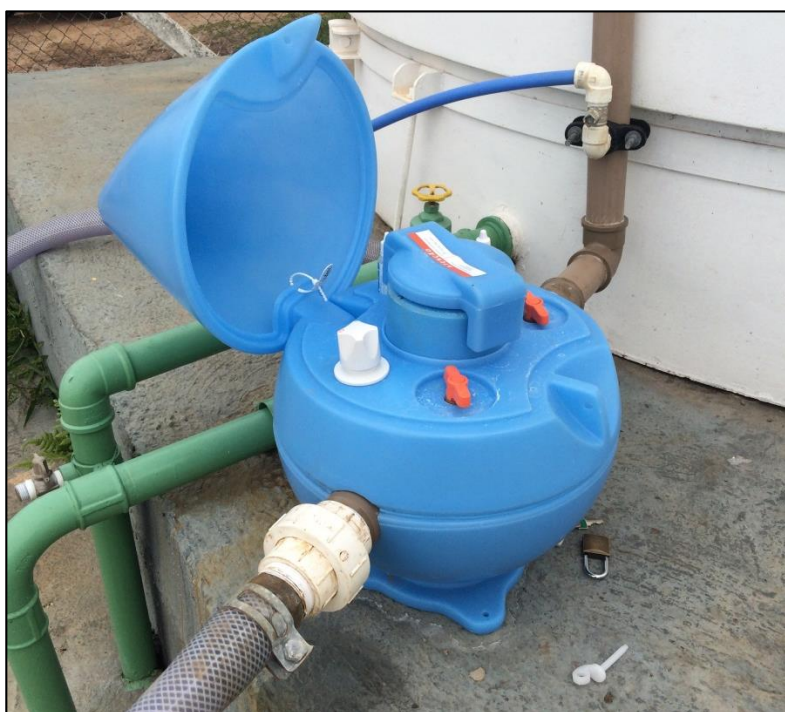
Figura 1: Sistema de dosagem hidráulica de cloro instalado.
