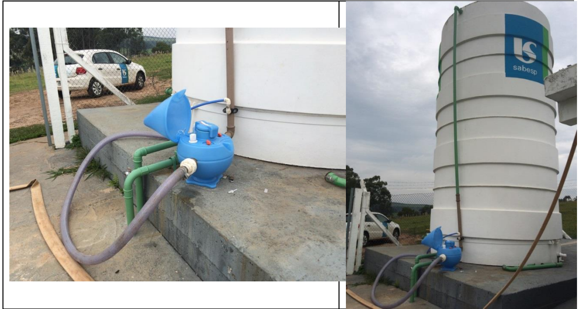
Figura 5. Fotografias do dosador hidráulico instalado junto aos reservatórios de armazenamento de água, Bairro César Neto, Distrito de Anhumas, Botucatu.
