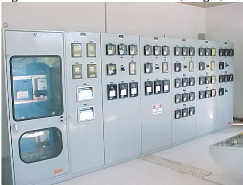
Figura 17: Relés Eletromecânicos (antigos)
