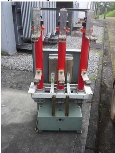
Figura 12: Disjuntor MT a PVO
