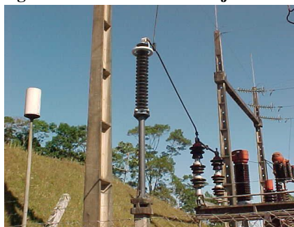
Figura 3: Para-raios de linha já instalados
