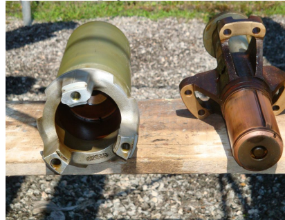
Figura 9: Inspeção da câmara de extinção
