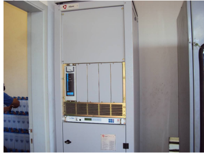
Figura 14: Novos bancos de baterias e Retificador de tensão
