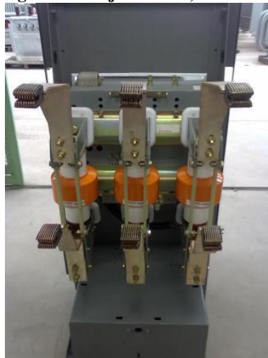
Figura 13: Disjuntor MT, com extinção à vácuo
