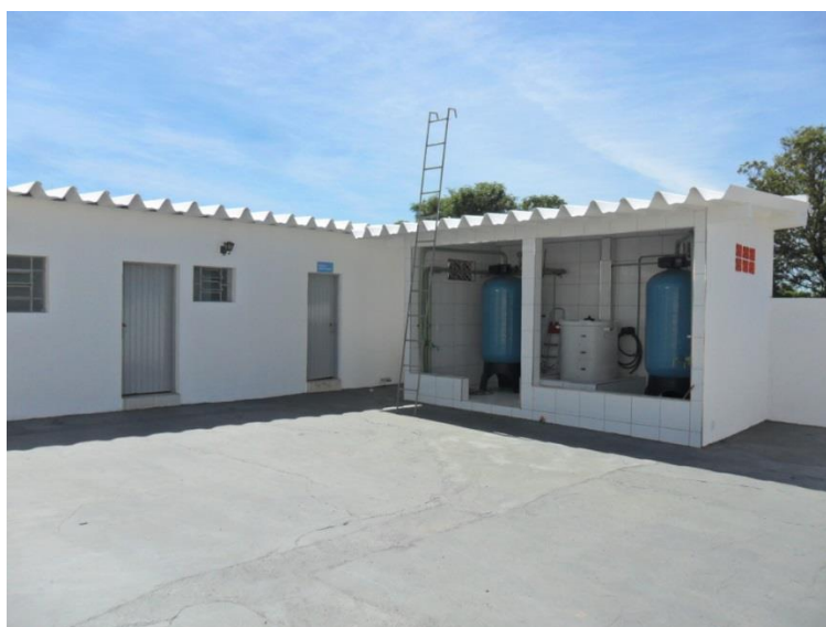
Foto 3: sistema de tratamento de Alfredo Marcondes. À esquerda, casa de bombas e casa de produtos químicos.
