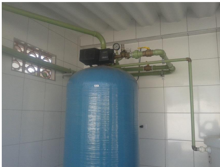
Foto 5: sistema de tratamento de Alfredo Marcondes. Detalhe das ligações e controlador.
