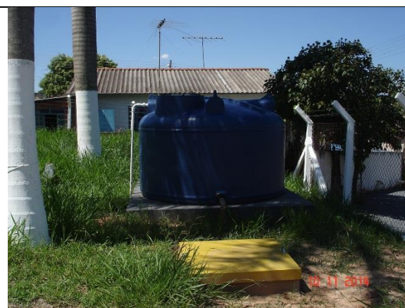
Foto 2: Sistema de tratamento de Araxans. Tanque de rejeitos
