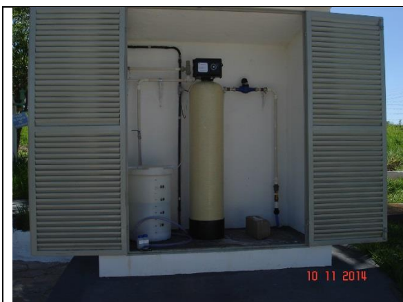
Foto 1: sistema de tratamento de Araxans. Leito de resinas (amarelo) e tanque de salmoura
