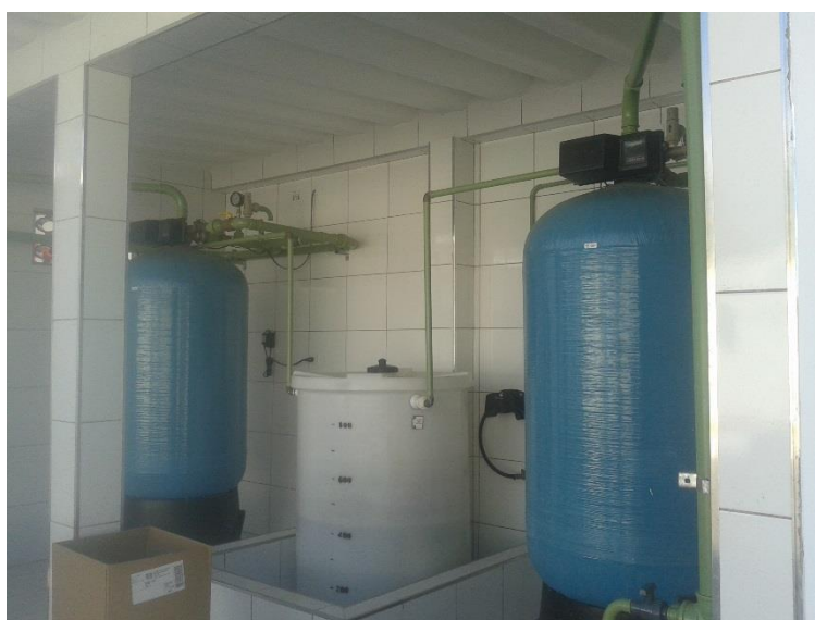
Foto 4: Sistema de tratamento de Alfredo Marcondes. Tanques de resina e tanque de salmoura (ao centro)
