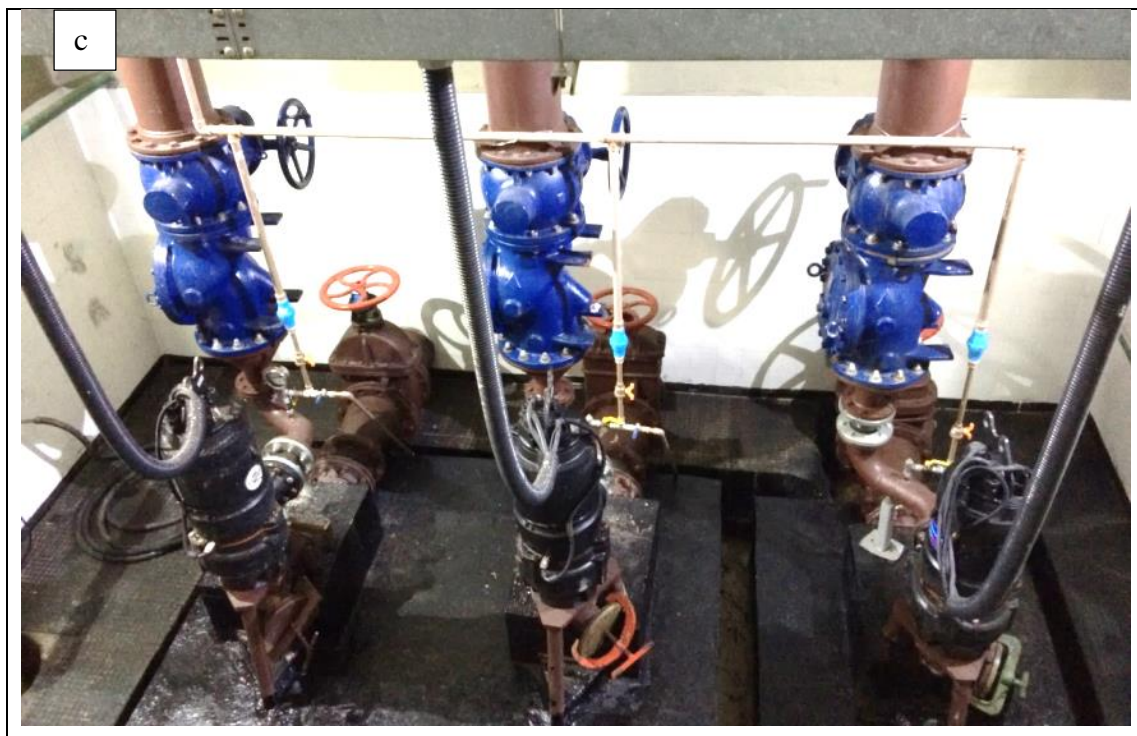
Figura 4: Ponto de instalação do analisador contínuo de DQO ao longo do trabalho: nas bombas de recalque do esgoto bruto (após caixa de areia).
