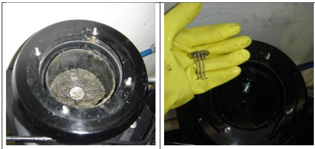
Figura 6: Peça de dispersão de fluxo na entrada do compartimento das lâmpadas e sensores UV/VIS, a qual foi retirada devido ao persistente problema de entupimento.
