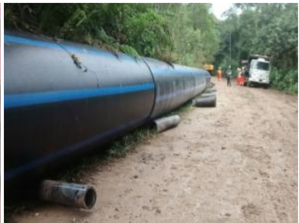
Figura 4: Adutora em PEAD
