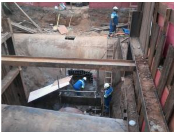
Figura 3: Adutora em concreto
