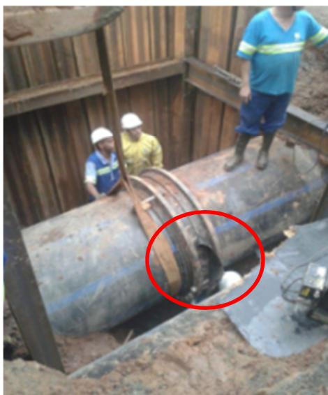
Figura 26: Junta de borracha expulsa durante a operação da tubulação.
