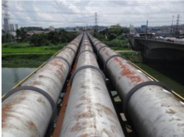
Figura 1: Adutora em aço
