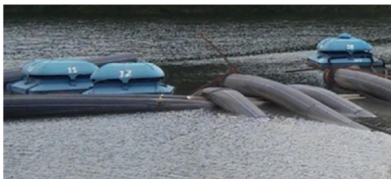
Figura 33: Tubulações deformadas após um período de inatividade.
