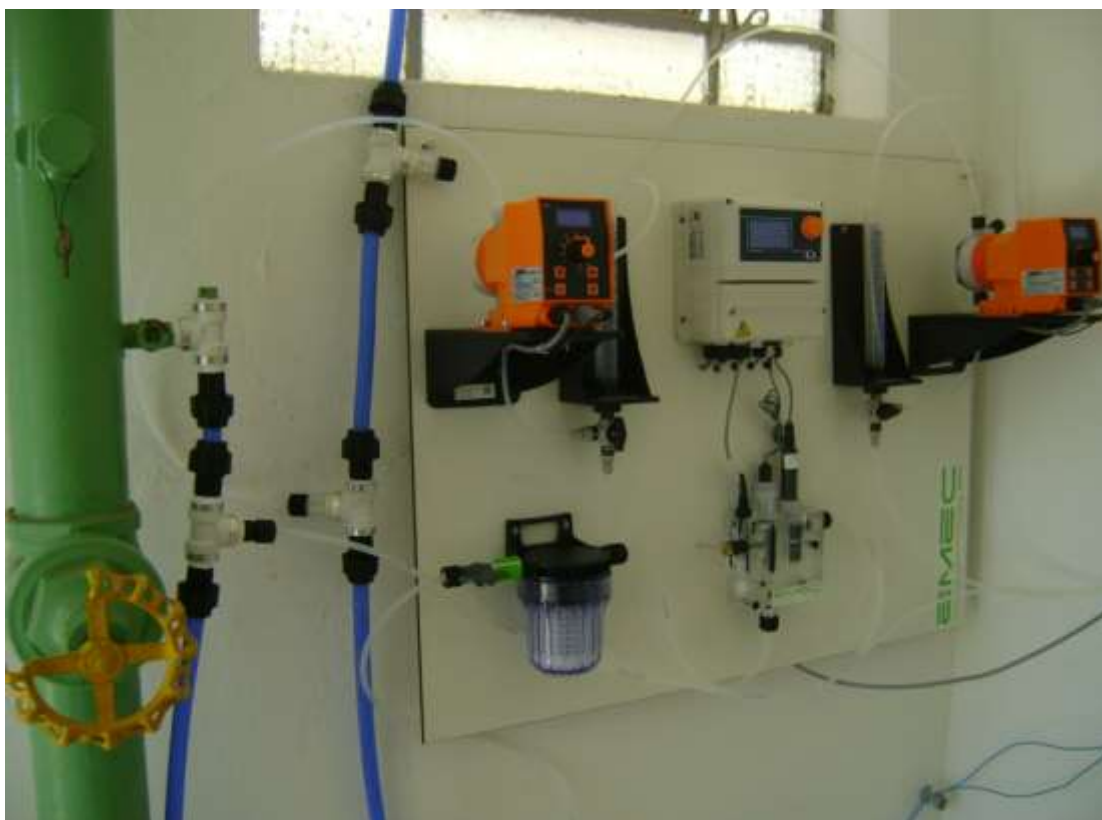
Figura nº 2: Painel com as bombas dosadoras, controlador, filtro e porta sondas
