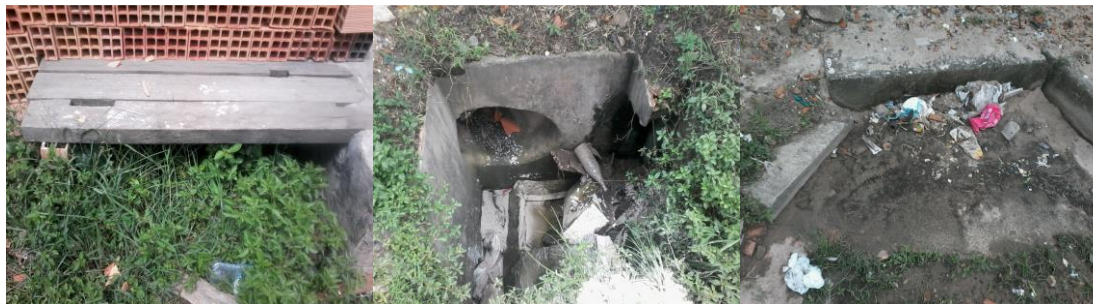
Figura 12: Identificação de problemas nas bocas de lobo
