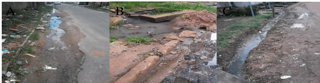
Figura 11: Identificação de problemas no meio fio
