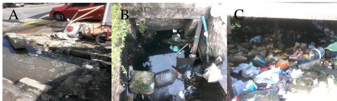
Figura 15: A) Boca de lobo entupida; B) e C) Resíduos no interior das bocas de lobo
