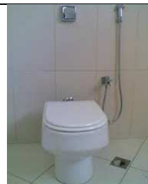
Figura 8 - bacia com válvula de descarga.
