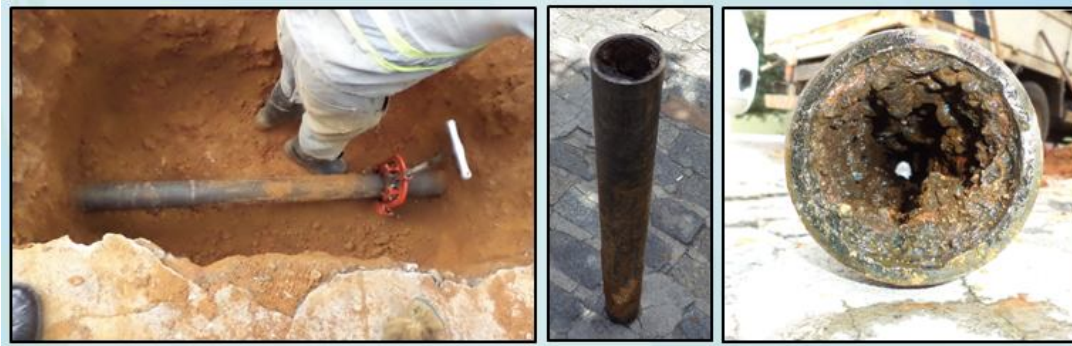
Figuras 2,3 e 4: Retirada da amostra de rede e aspecto interno da tubulação
