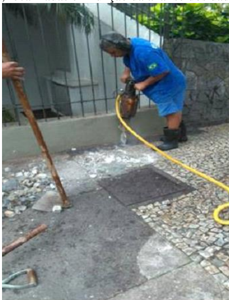
Figura 4: Após a localização de vazamento oculto procede-se a abertura para reparo.
