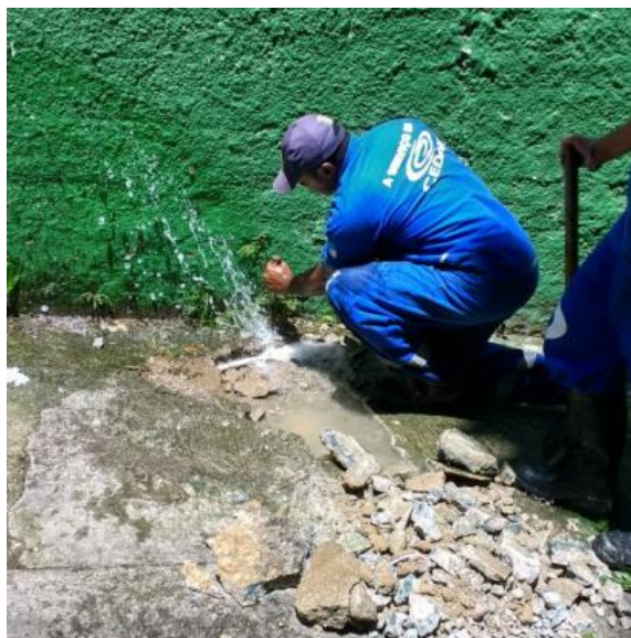
Figura 9: Cliente cortado sendo abastecido por ligação clandestina.
