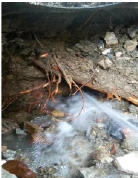
Figura 5: O vazamento finalmente exposto para ser reparado após abertura.
