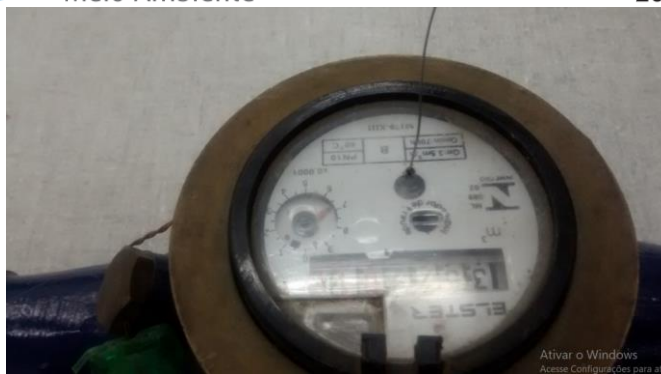
Figura 10: Hidrômetro com a cúpula perfurada e com a relojoaria travada.
