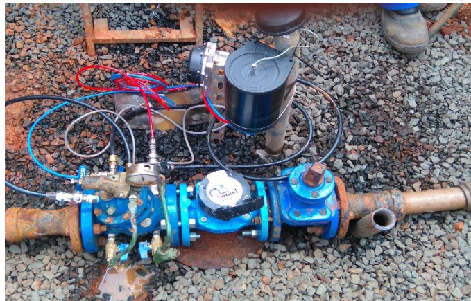
Figura 2: Macromedidor, VRP e sensor de pressão
