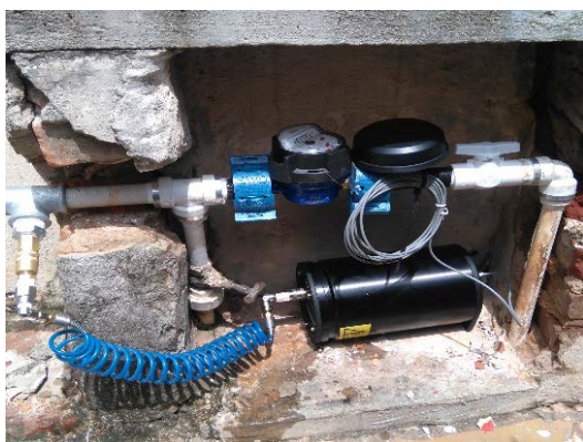
Figura 3: Sensor de pressão do ponto crítico baixo
