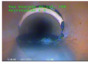
Fig. 4 - Junta deslocada Fonte: Arquivo do autor
