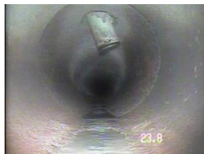
Fig. 7 - Conexão irregular de ramal Fonte: Arquivo do autor.
