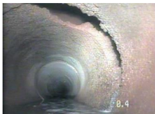
Fig. 6- Trinca na tubulação Fonte: Arquivo do autor.
