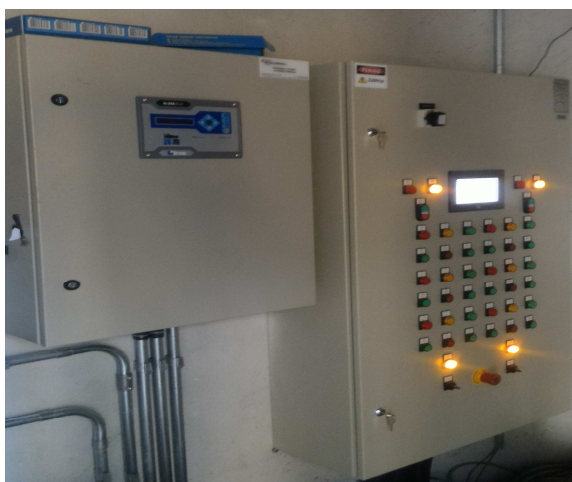
Figura 4: Painel do CLP com IHM e USCA do Gerador instalado na sala de controle da Barragem Pedro Beicht.
