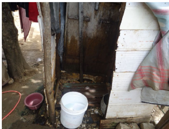
Figura 11: Estrutura sanitária precária de domicílio enquadrado em condição de vulnerabilidade social na cidade de Santana do Ipanema-AL
