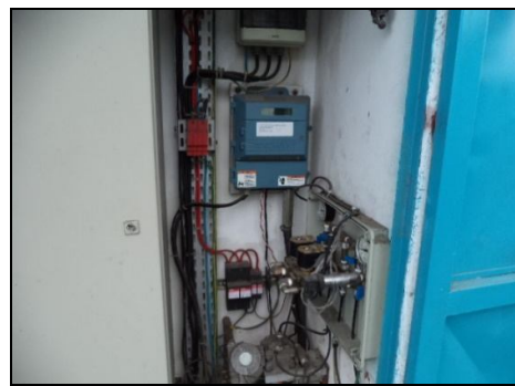
Figura 5 – Instalações em Monolito.
