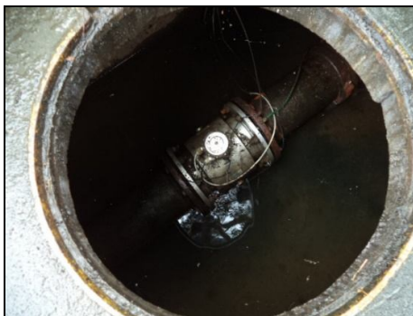
Figura 4 - Macromedidor Primário vistoriado.
