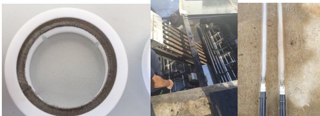
Figura 7 novo sistema de limpeza e tubos com flouling
