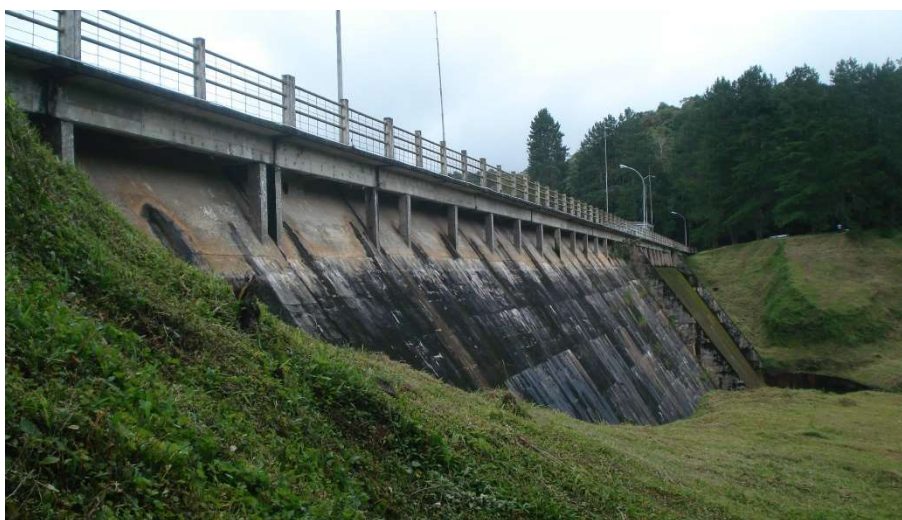
Foto 4: barragem Ribeirão do Campo do Sistema Rio Claro. Barragem do tipo gravidade
