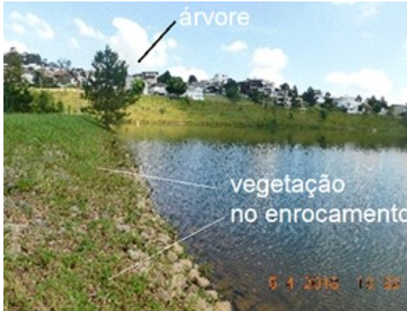
Foto 7: Barragem Morada dos Lagos do Sistema Aldeia da Serra, estrutura em destaque talude de montante.
