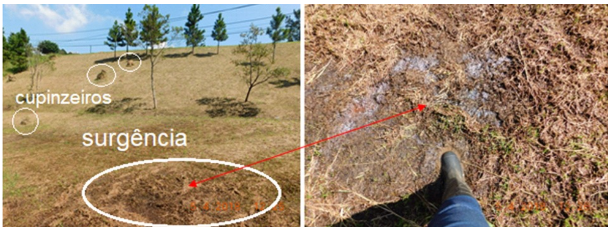
Foto 8: Barragem Morada dos Lagos do Sistema Aldeia da Serra, estrutura em destaque pé de jusante.
