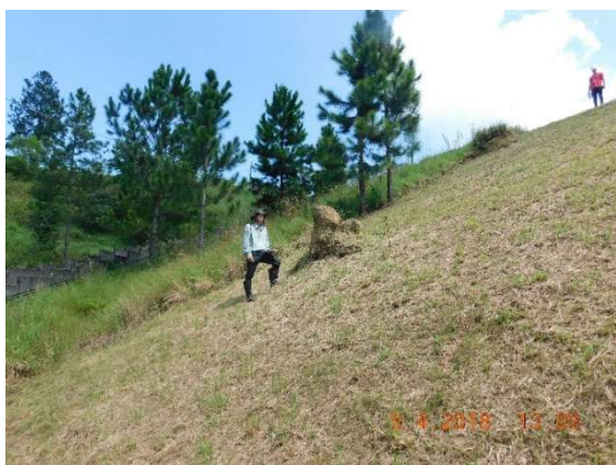
Foto 6: Barragem Morada dos Lagos do Sistema Aldeia da Serra, estrutura em destaque talude de jusante.
