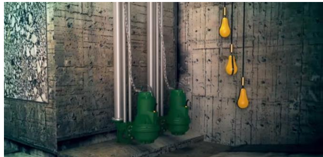
Figura 30 – Bombas de recalque na estação elevatória. Fonte: Rolo & Pereira Ltda.
