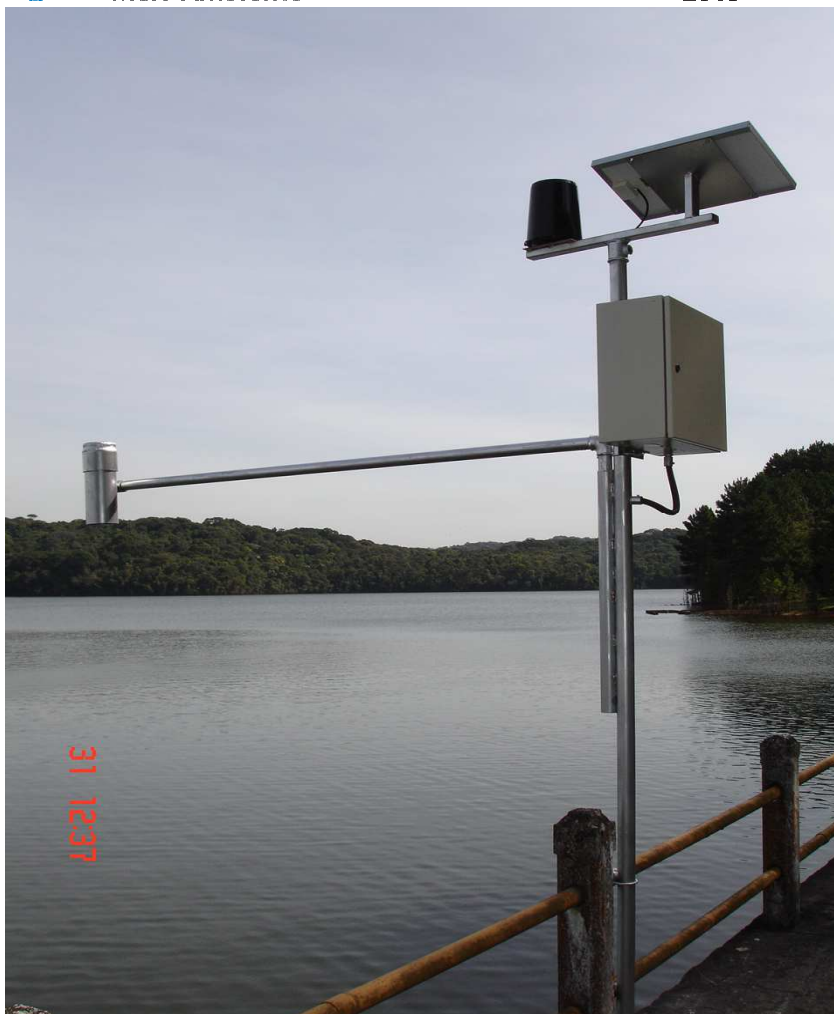
Figura 2: estação telemétrica Sabesp
