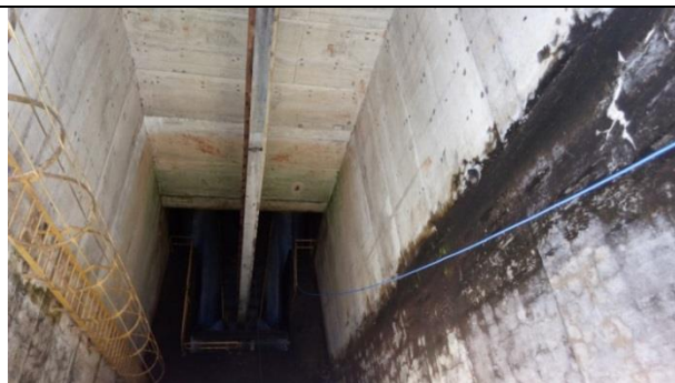
Figura 9: Aplicação do produto químico após a comporta.
