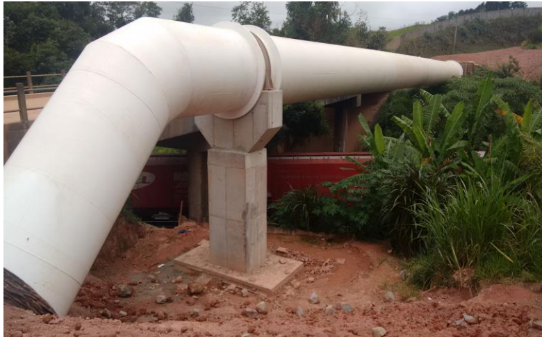
Figura 08: Adutora sobre apoio de concreto armado
