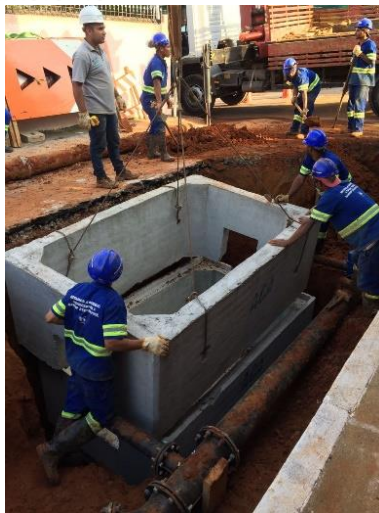
Caixa estrutural e By-pass
