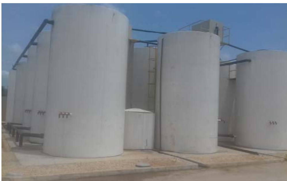
Figura 05 – Fotos reatores anaeróbios seguidos dos filtros anaeróbios da ETE Viver Melhor Marituba.
