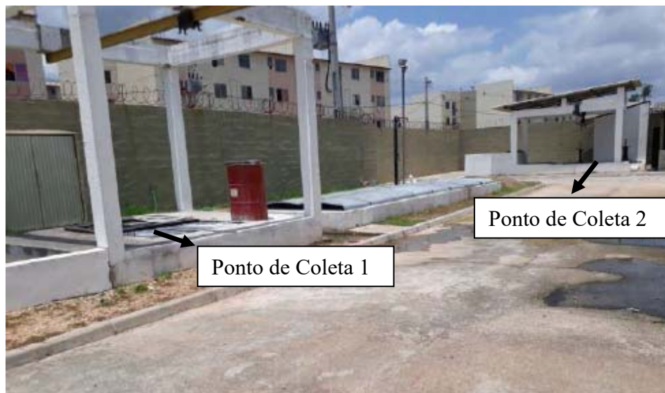
Figura 06 – Fotos da localização dos pontos de coleta 1 (entrada) e 2 (saída) da ETE Viver Melhor Marituba.
