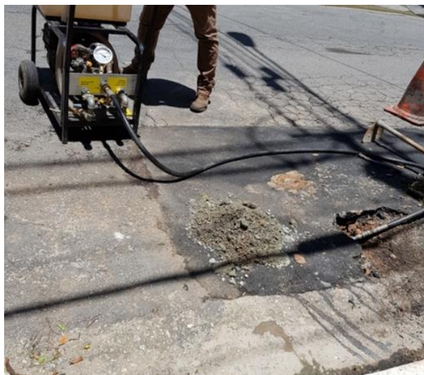
Figura 2: Ponto de instalação.
