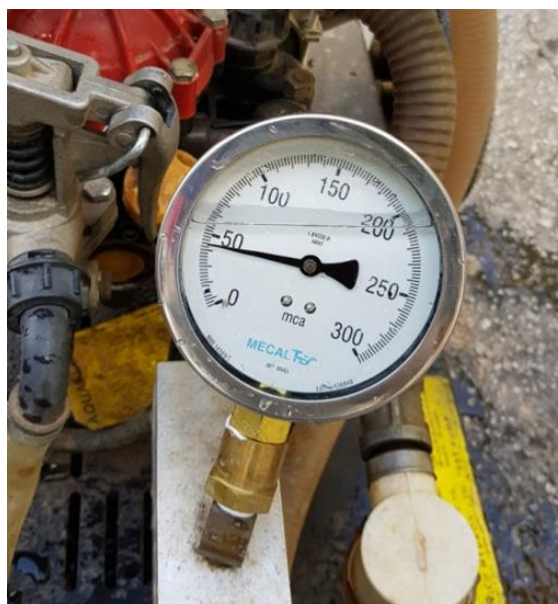
Figura 3: Registro da pressão de trabalho da rede
