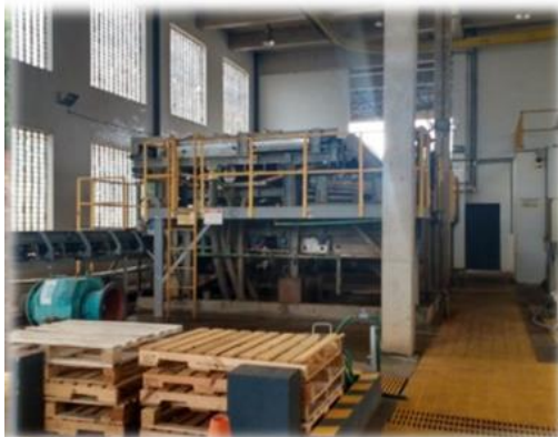
Figura 7 - Unidade de Desaguamento.
