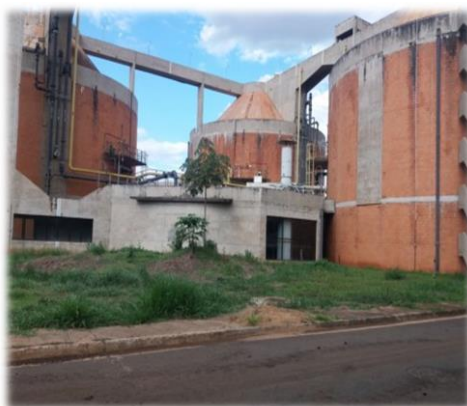
Figura 6 - Digestores Anaeróbios de Lodo.
