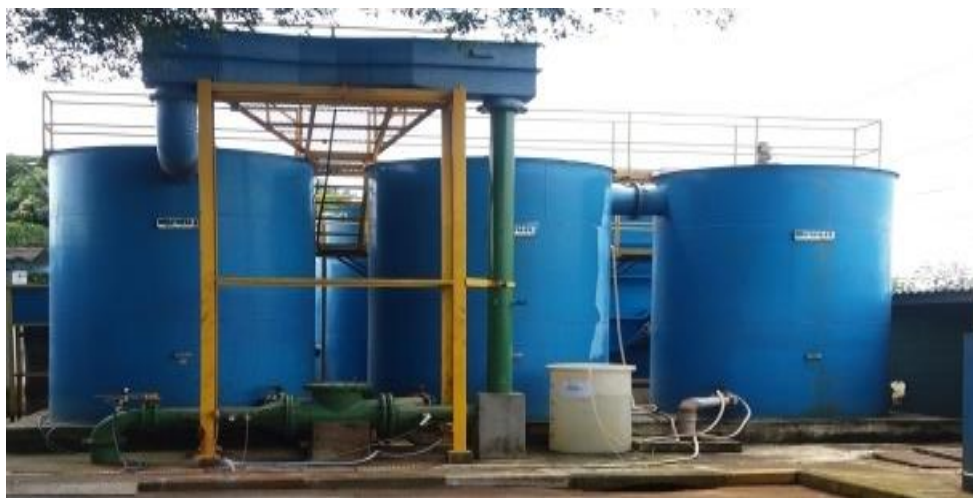
Figura 3: Visão parcial dos flocladores da ETA Santana de Parnaíba
