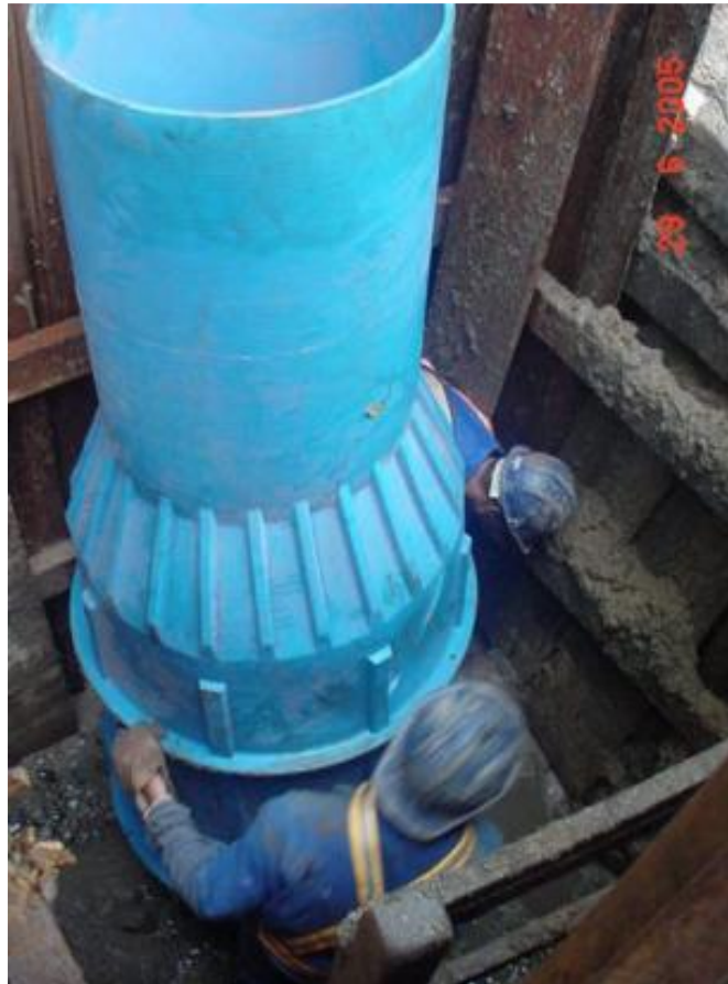
Figura 7: Descida do PV.
