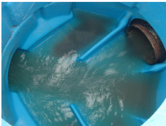
Figura 18: Vista interna de uma ligação em operação.
