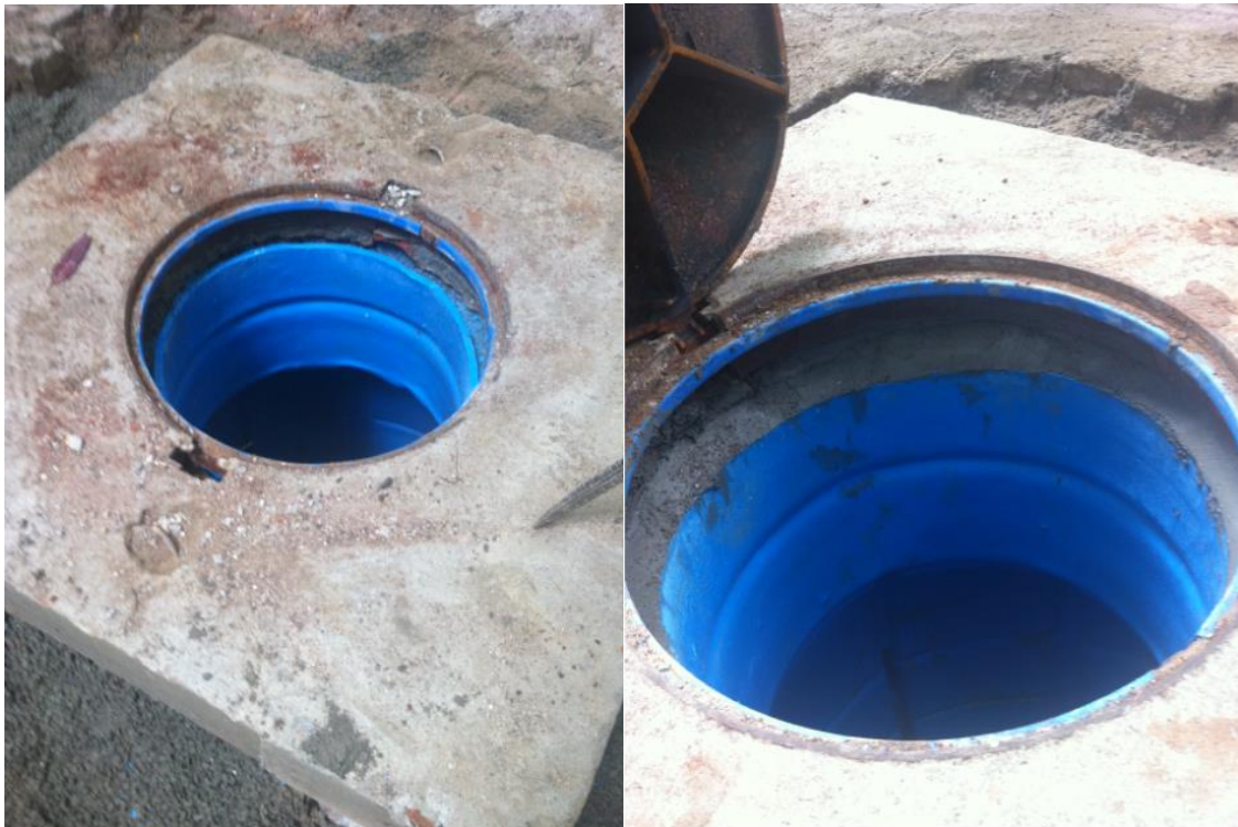
Figura 12: Laje instalada sem apoio sobre o PV.
