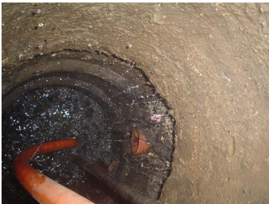
Figura 20: Infiltrações em PVs de concreto.
