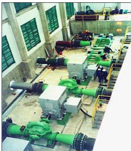
Figura 3: Estação elevatória fixa (em terra).
