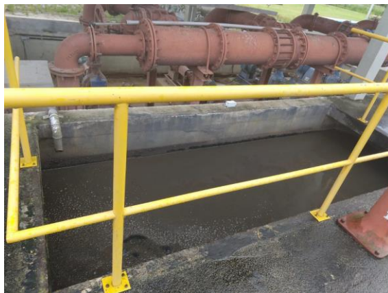
Figura 1. Elevatória de retorno de lodo dos Sistemas de Lodos Ativados. Fonte: Próprio Autor.
