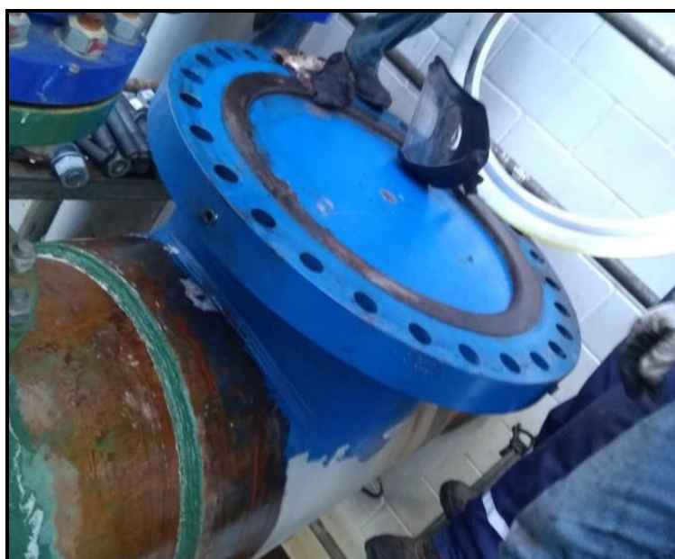
Figura 31 – Tampa de bloqueio provisório já inserida no tee bi-partido
