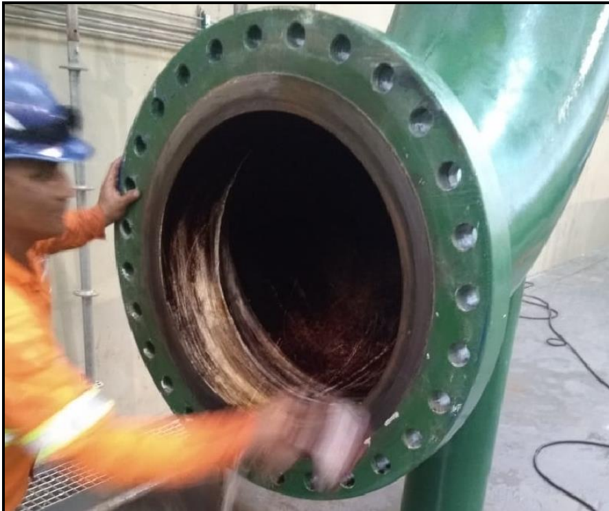
Figura 28 – Nesta foto verifica-se a desmontagem da válvula de bloqueio e o flange do tramo interligado na adutora completamente aberto e estanque.
