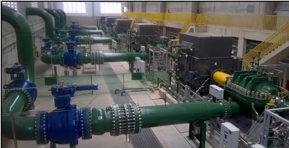
Figura 3 – Foto da Vista Interna da EEAB- AC
