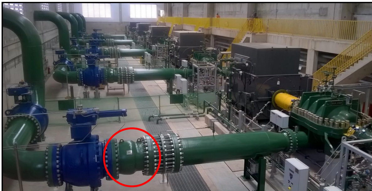
Figura 3 – Foto da Vista Interna da EEAB- AC (Detalhe da válvula de retenção)
