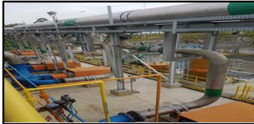
Foto 1-Tubulações do sistema de membranas Fonte: o autor, 2018
