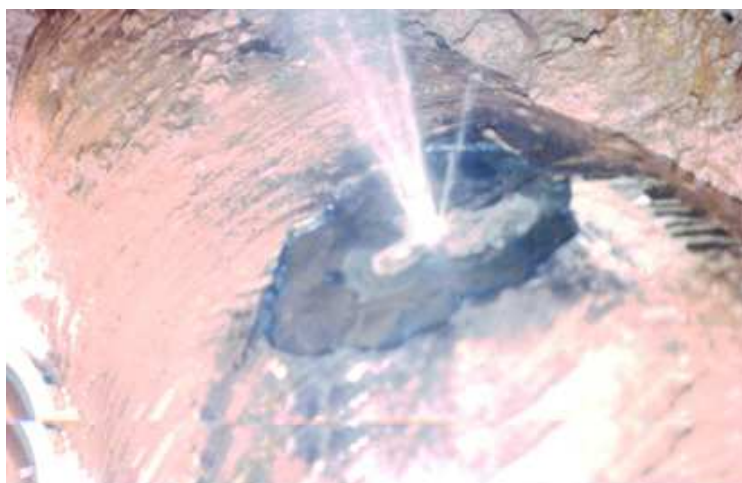
Figura 2: Furo em uma adutora enterrada causado por corrosão. Somente a instalação do sistema de proteção catódica consegue evitar que problemas como esse aconteçam.
