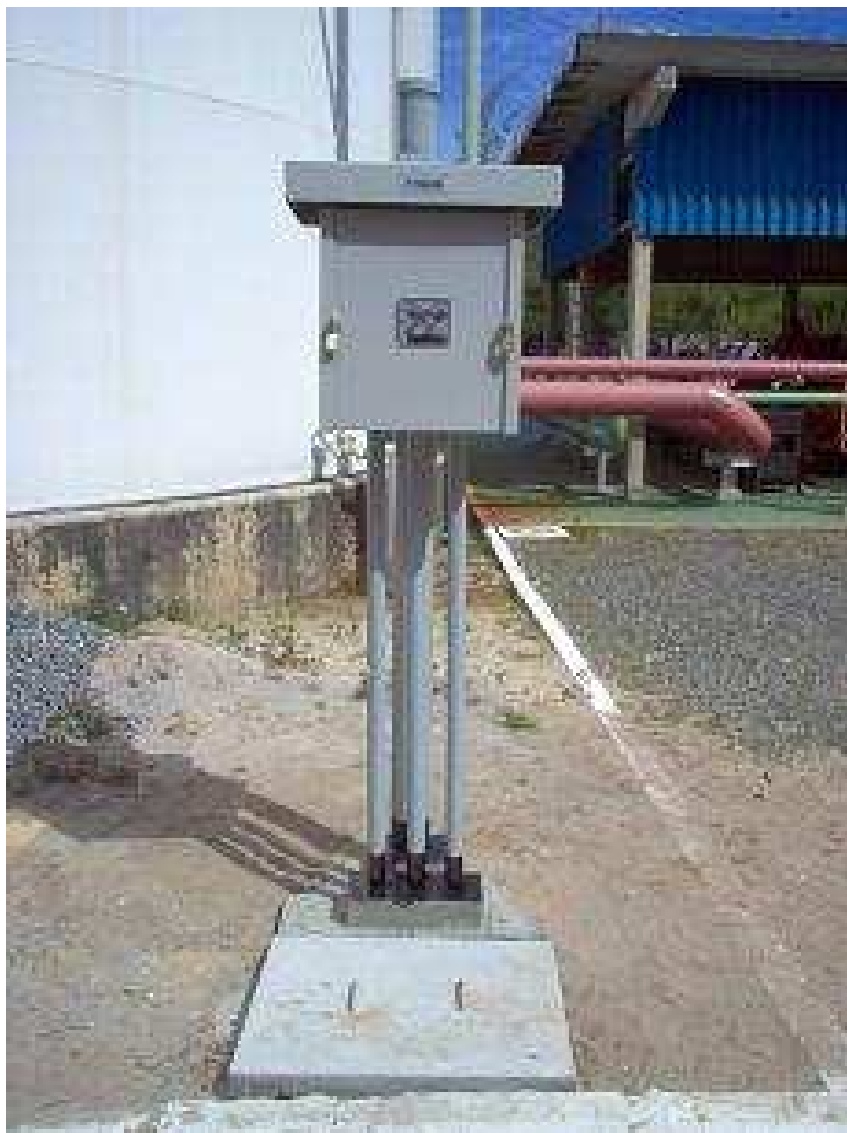
Figura 7: Retificador de proteção catódica para a proteção de um tanque de armazenamento de água.
