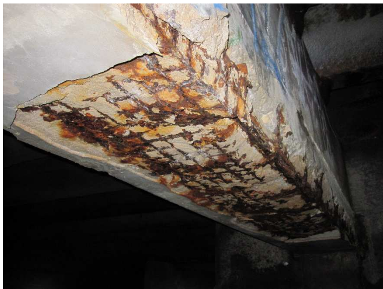
Figura 4: Corrosão em estrutura de concreto de Estação de Tratamento de Esgoto. Esses problemas somente podem ser resolvidos em definitivo com a instalação dos anodos de proteção catódica.
