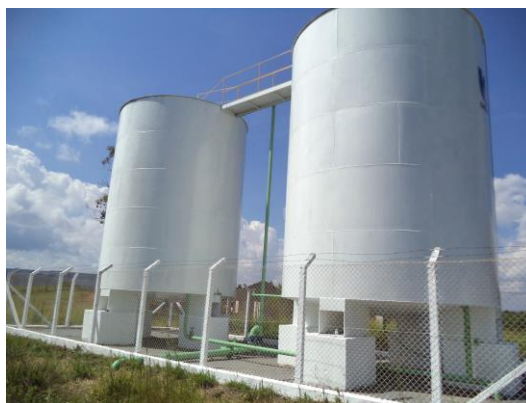
Figura 12: Reservatórios de BSI
