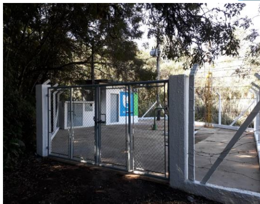
Figura 11: Poço profundo PPI de BSI
