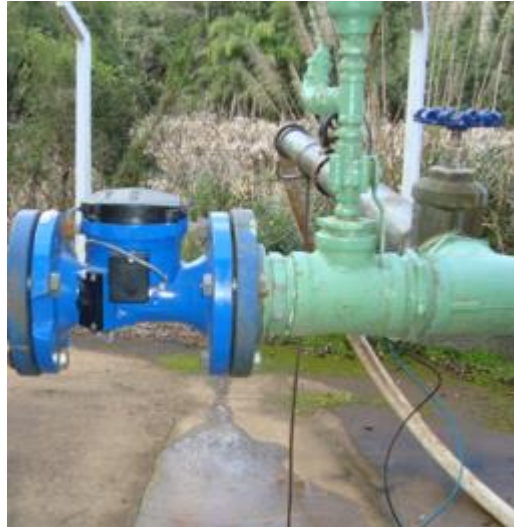
Figura 14: BSI – Macromedidor de Produção - Ultrassônico Arad Octave – Poço PP01
