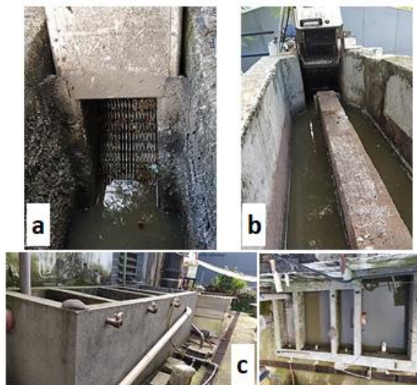
Figura 1 – Sistema de tratamento preliminar: Gradeamento (a); Canal de areia (b); caixa separadora água/óleo (vista lateral e superior)
