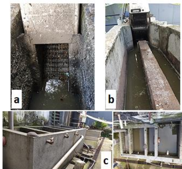
Figura 1 – Sistema de tratamento preliminar: (a) Gradeamento; (b) Canal de areia; (c) caixa separadora água/óleo (vista lateral e superior)
