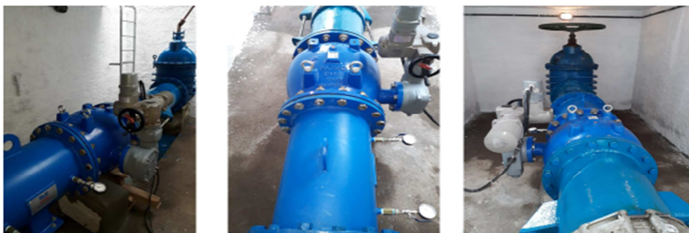
Figura 6: Entrada de água na linha do by-pass (Fonte: Instalação no reservatório de Perus)
