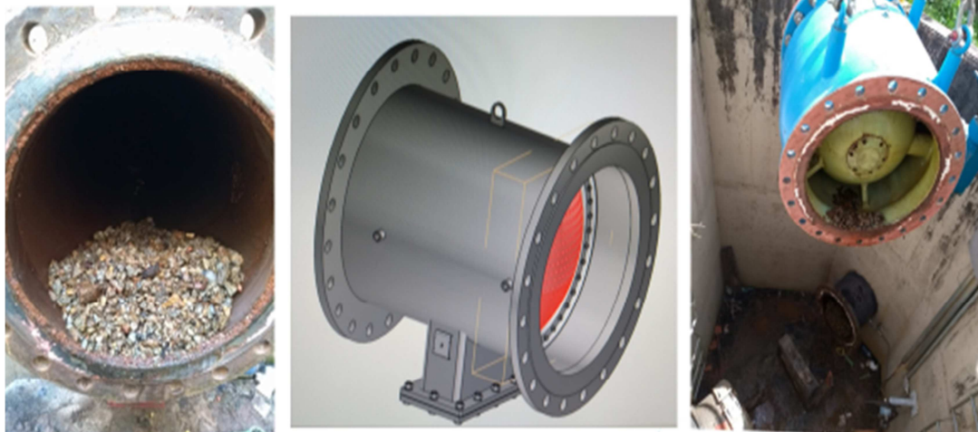
Figura 2: Obstrução na válvula de controle (Fonte: Reservatório de Francisco Morato-Centro)
