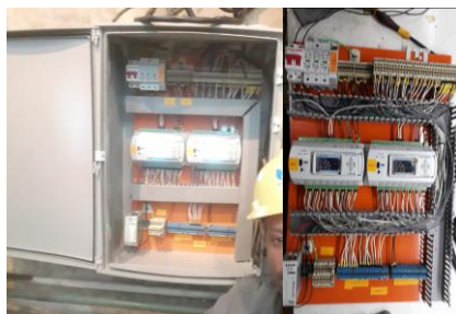
Figura 4 – montagem do painel de instrumentação com os transmissores NOVUS fieldlogger.
