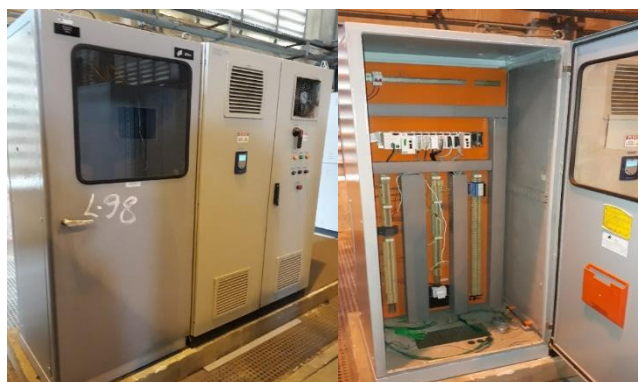
Figura 2 – painel de controle e controlador lógico (CLP) utilizado no projeto.
