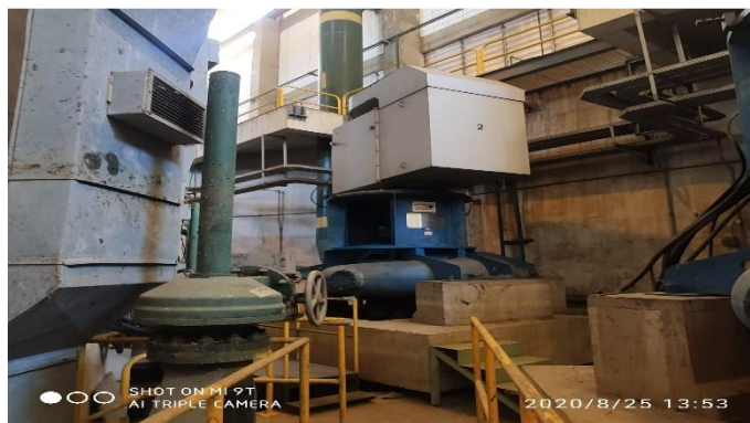
Figura 1 – conjunto motor bomba da primeira fase do projeto.
