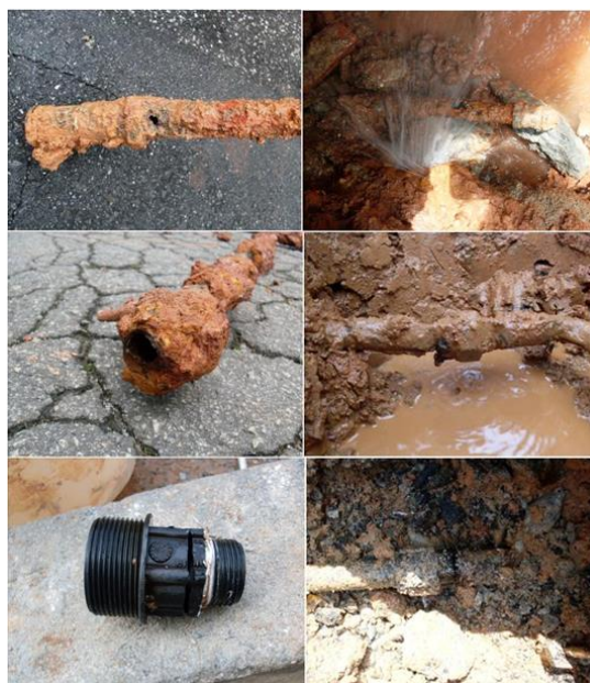
Figura 02– Problemas de infraestrutura encontrados
