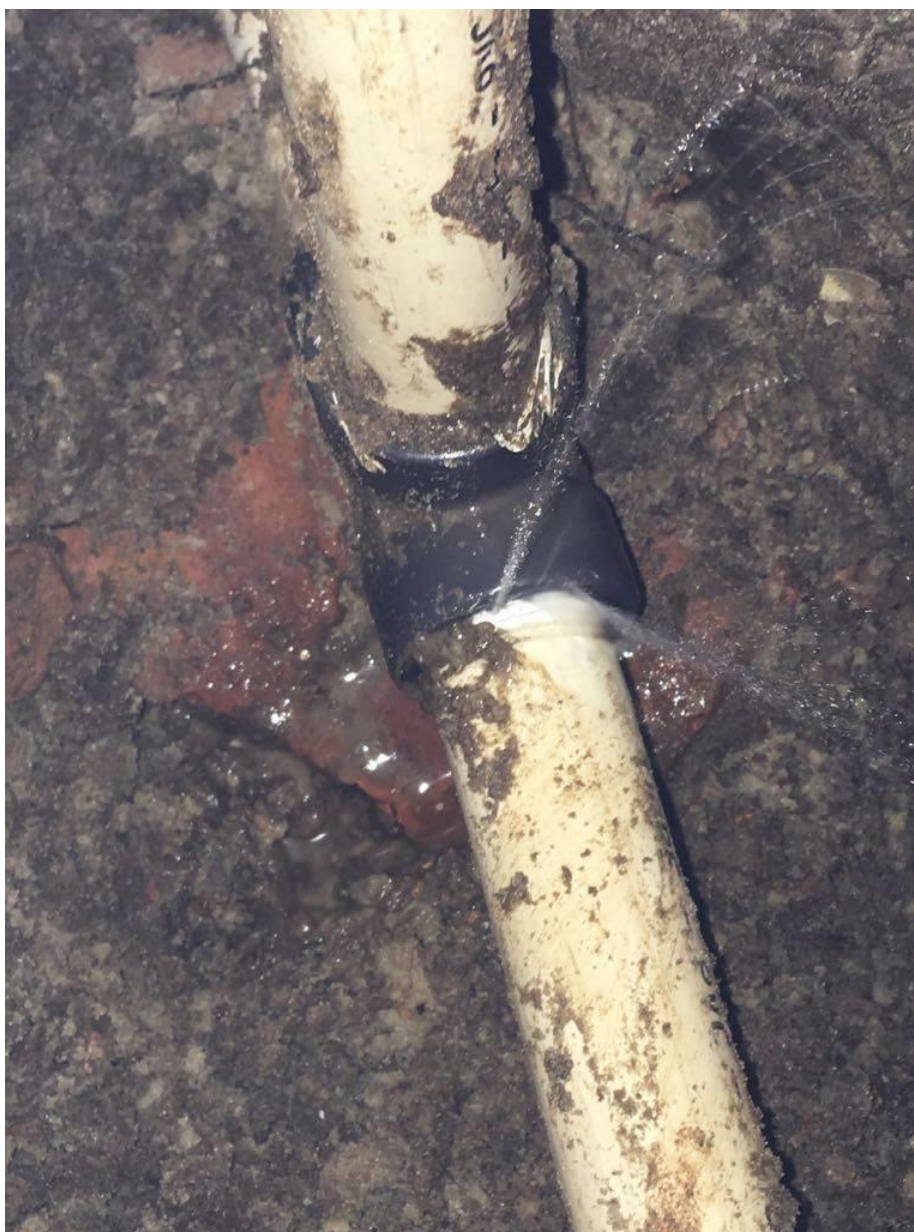
Figura 01 – Exemplo de Vazamento Interno (Fonte: do Autor)
