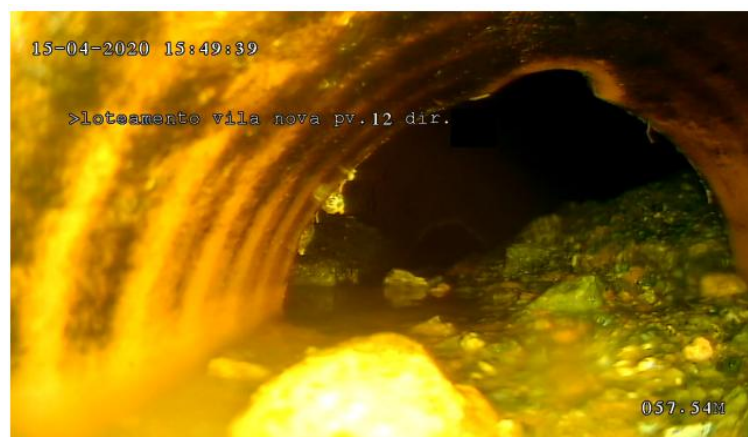
Figura 9: Rede de esgoto quebrada, com entrada de material.
