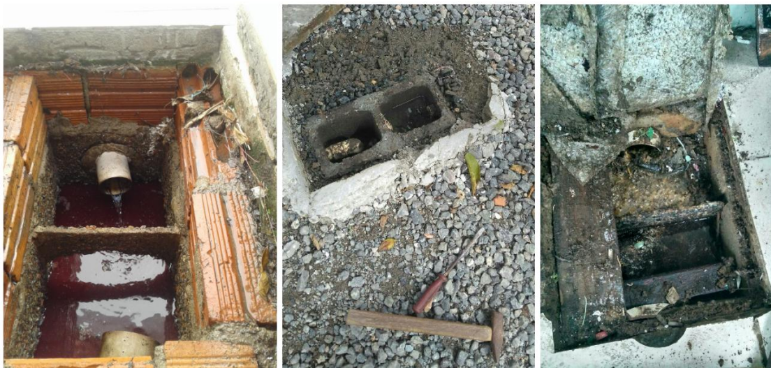
Figura 12: Caixas de gorduras irregulares.
