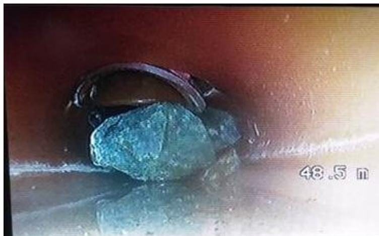
Figura 8: Obstrução por selim e pedra, impedindo o fluxo.
