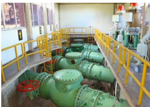
Figura 15: Instalação hidráulica da EEA Sifão 22
