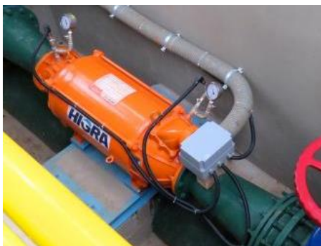
Figura 7: Minicentral hidrelétrica instalada no reservatório Mussolini (HIGRA, 2020)
