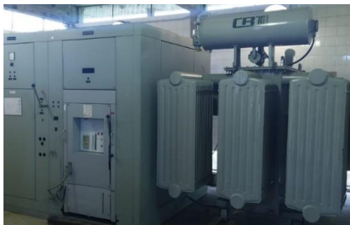
Figura 14: Transformador trifásico na EEA Sifão 22
