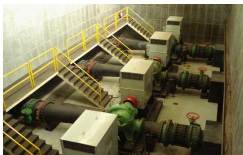
Figura 5: Estação Elevatória de Água Tratada ABV
