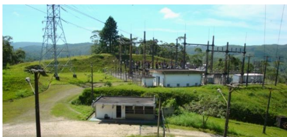
Figura 13: Subestação transformadora na EEA no Sifão 22
