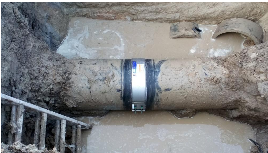
Fotografia 2 – Trecho com vazamento reparado com a abraçadeira universal
