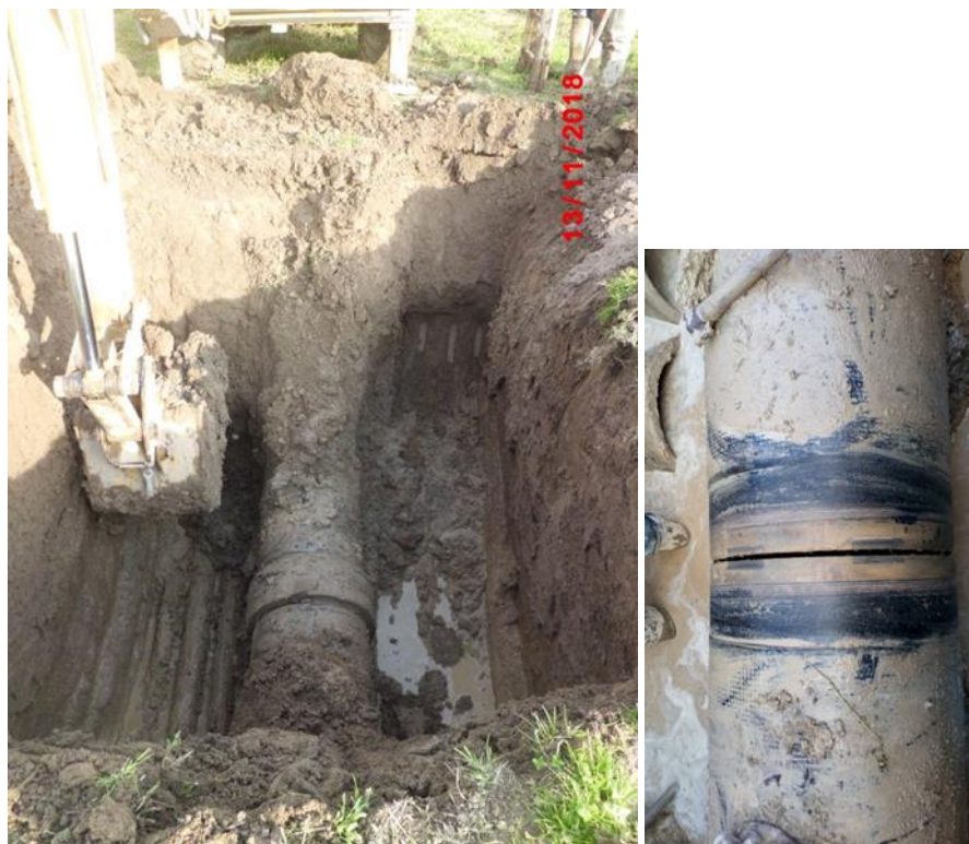
Fotografia 1 – Trecho com vazamento a ser reparado
