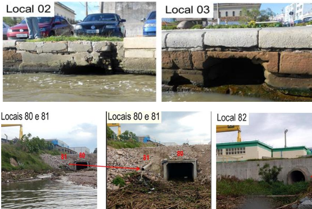
Figura 5- Identificação de efluentes pluviais desaguando por galerias com ligações clandestinas de esgotos sendo lançados nas águas do estuário. Fonte: Aguiar et al. 2014).
