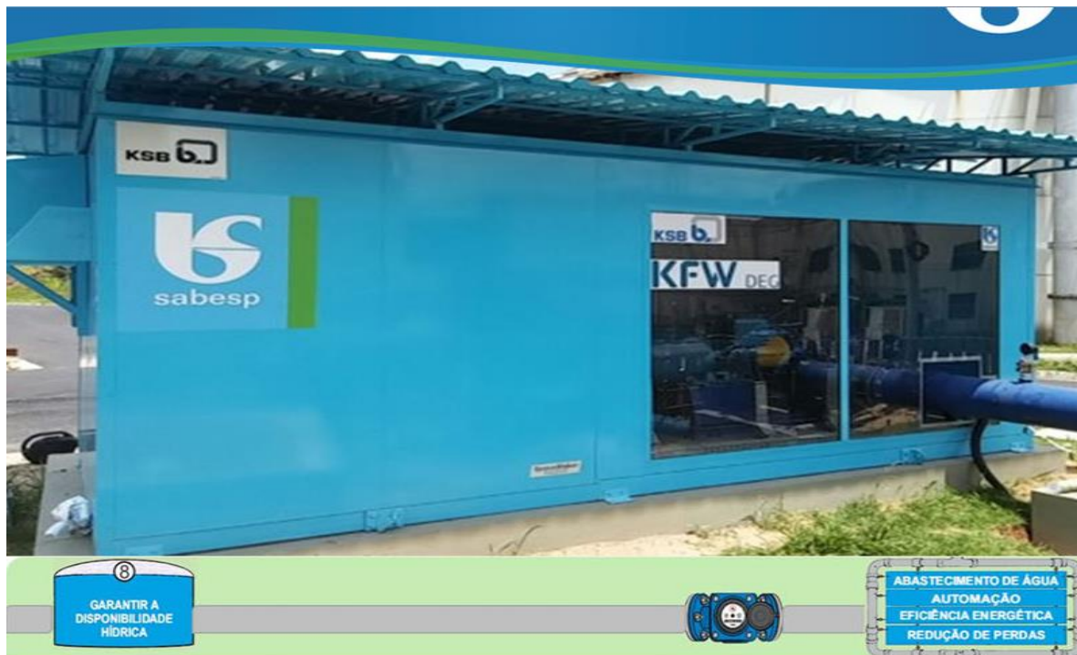
Figura 10: BFT passa a ser operada pelo Centro de Controle Operacional CCO) (fonte: Sabesp-2019)
