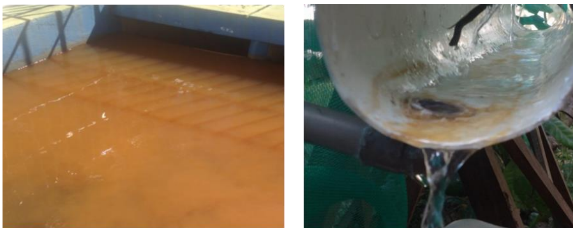
Figura 12 – Água de lavagem de filtros Fonte: Própria
