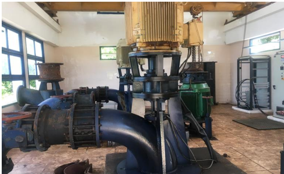
Figura 2 - ETA Lagoa do Jiqui – Bombas de captação Fonte: Própria
