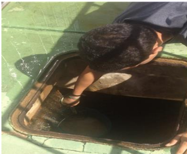
Figura 5 - ETA Lagoa do Jiqui – Caixa de inspeção Fonte: Própria
